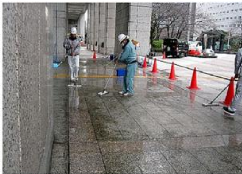
床を洗浄後、特殊な薬剤を塗って滑り止め工事をする作業員＝防滑業振興協会提供
